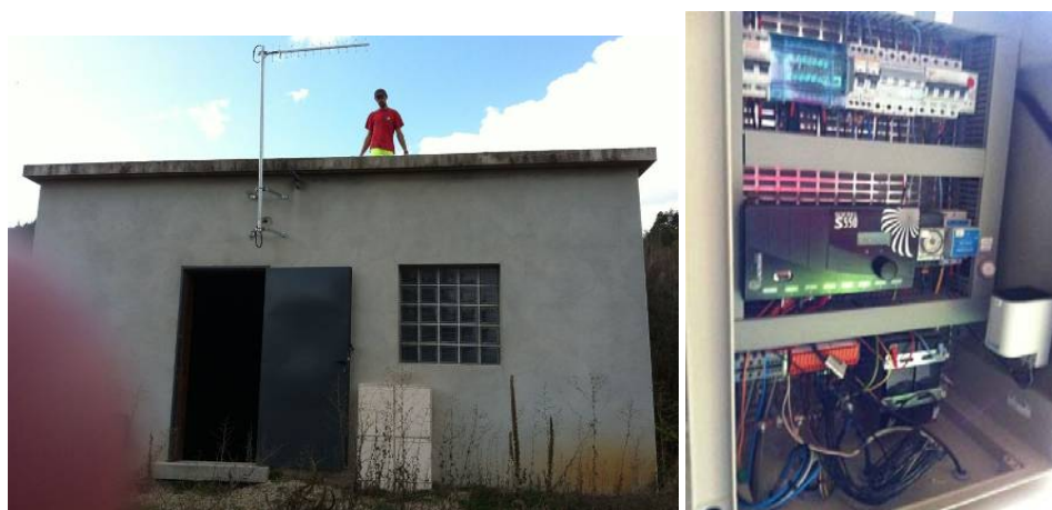
Photos du réservoir de Marance (entrée et télégestion)
