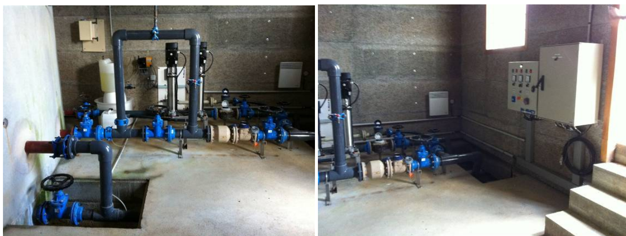
Photos du réservoir de Marance (chambre des vannes)
