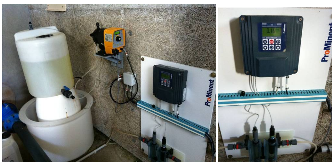
Chloration au réservoir de Marance (pompe doseuse, réservoir de chlore et mesure en continu)
